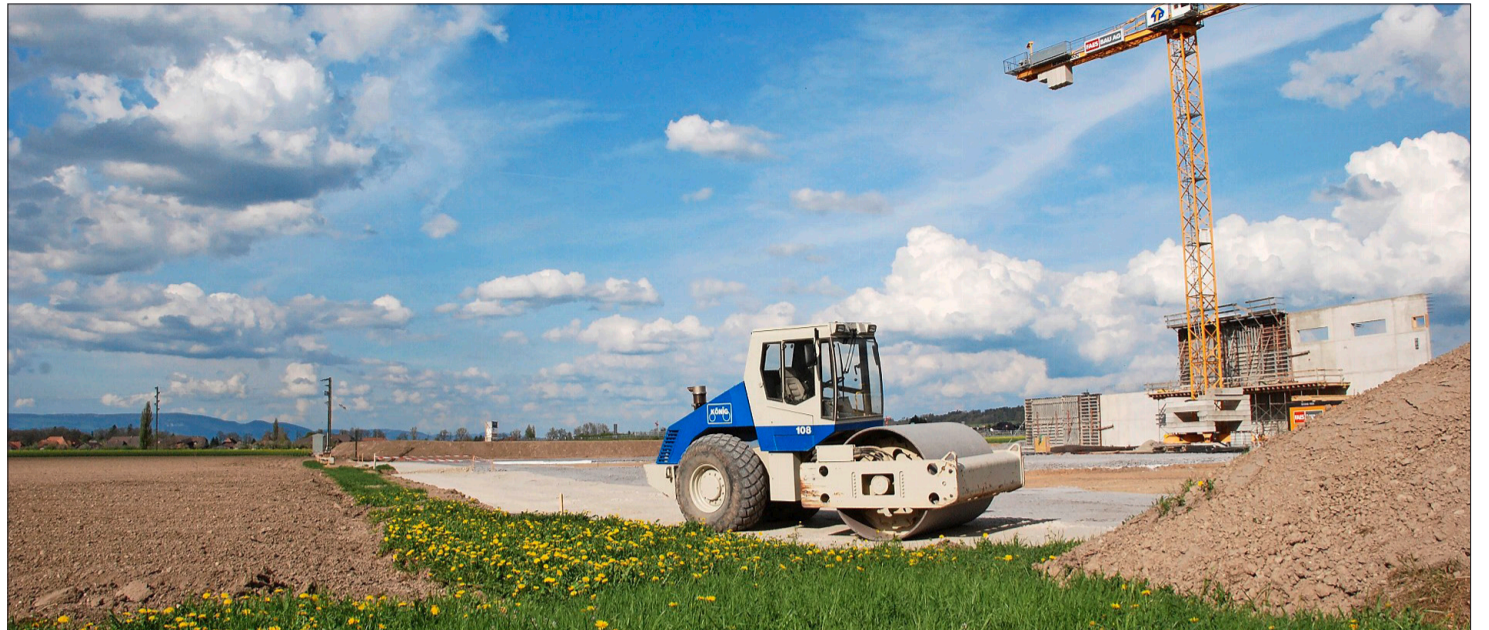
Bei Infrastrukturprojekten kann es sein, dass Landwirtschaftsland als Deponiefläche beansprucht werden muss. (Bild: Robert Alder)
